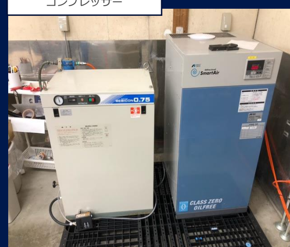
コンプレッサー
